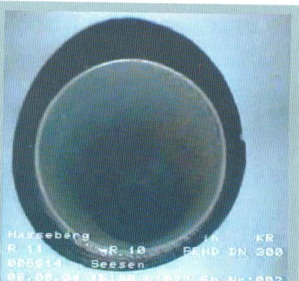
Рис. 5. Снимок канализационного трубопровода на участке соединения труб, полученный в ходе технического осмотра с использованием видеокамеры.
